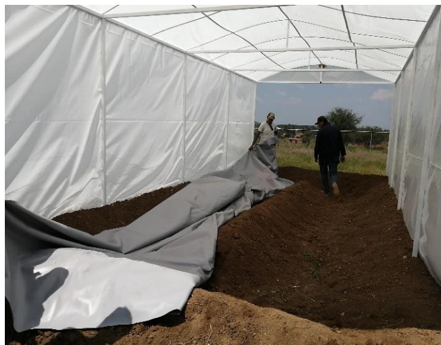
Fig. 7. Raceway, cubierta de geomembrana.
